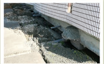
建物北側の地盤沈下
