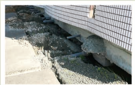
建物北側の地盤沈下
